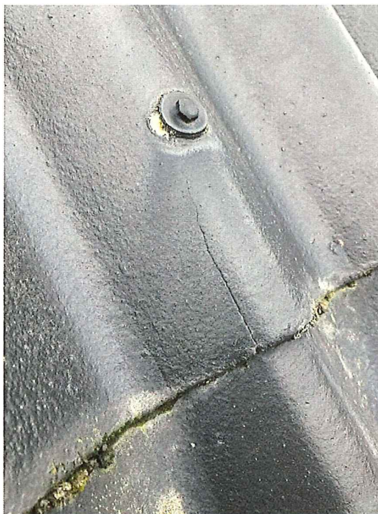
Foto 10 Revne i tagplade ved overlæg.
