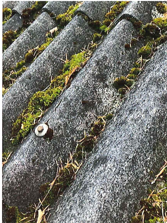
Foto 8 Mos på tag samt overfladerevne i tagplade.
