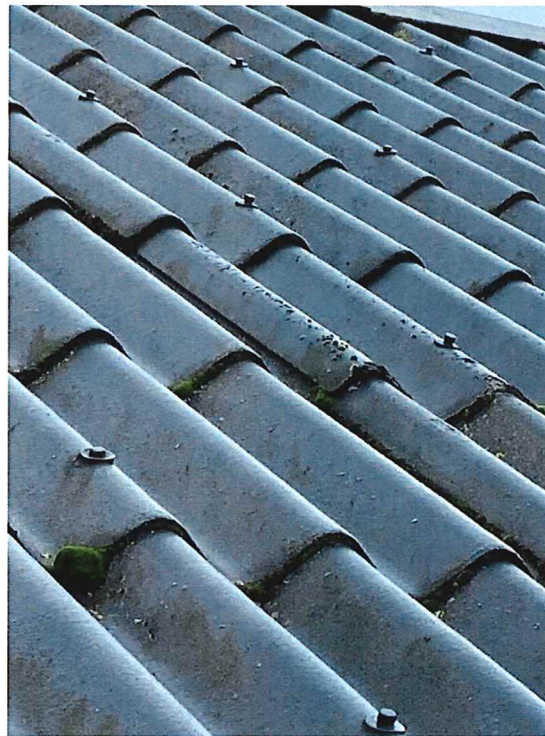
Foto 2 Afskalning i bund af tagplade.
