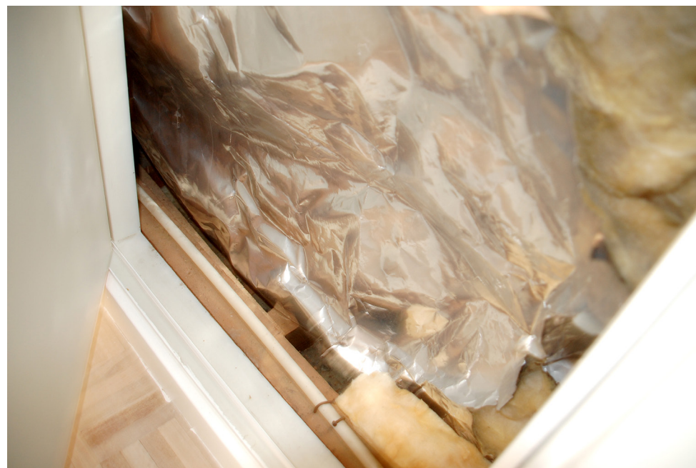
Utæt dampspærre bag skunkvæg
